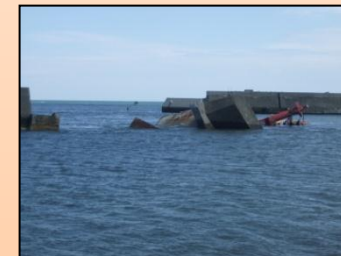
津波による防波堤の倒壊
