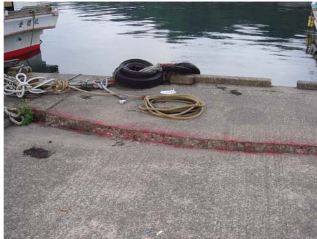
物揚場舗装面の沈下・段差(出雲崎漁港)
