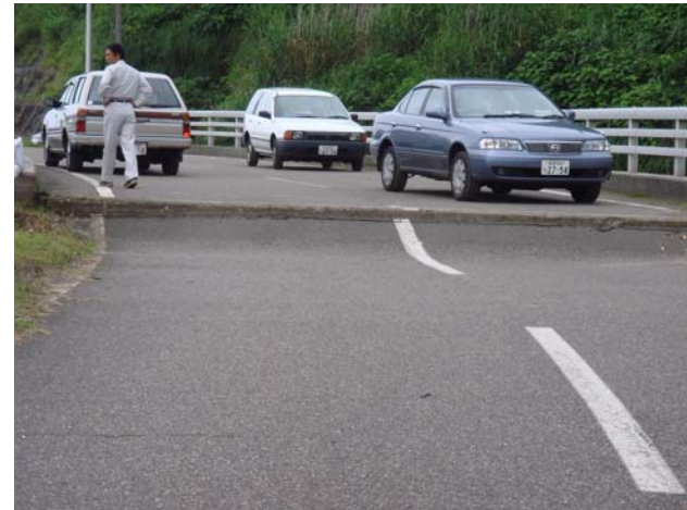
道路の沈下・段差(笠島漁港)
