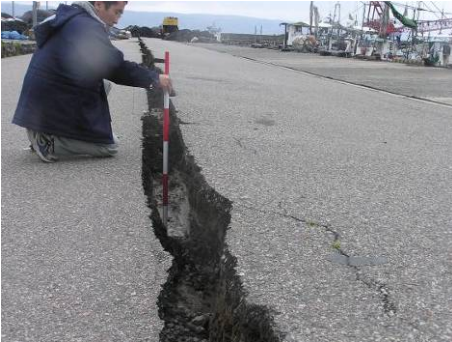
道路舗装の亀裂と隆起
