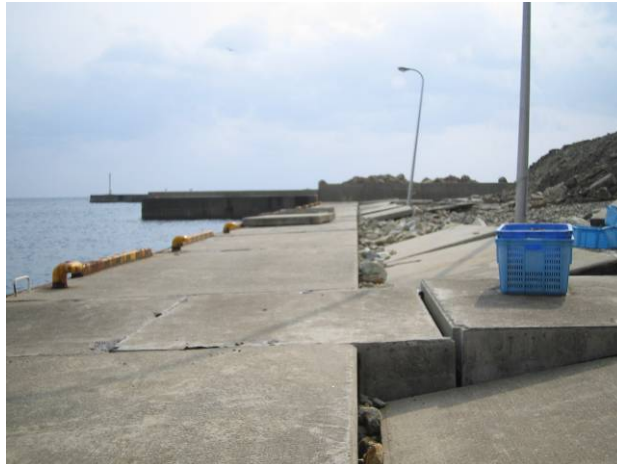
岸壁の破損(水津漁港)
