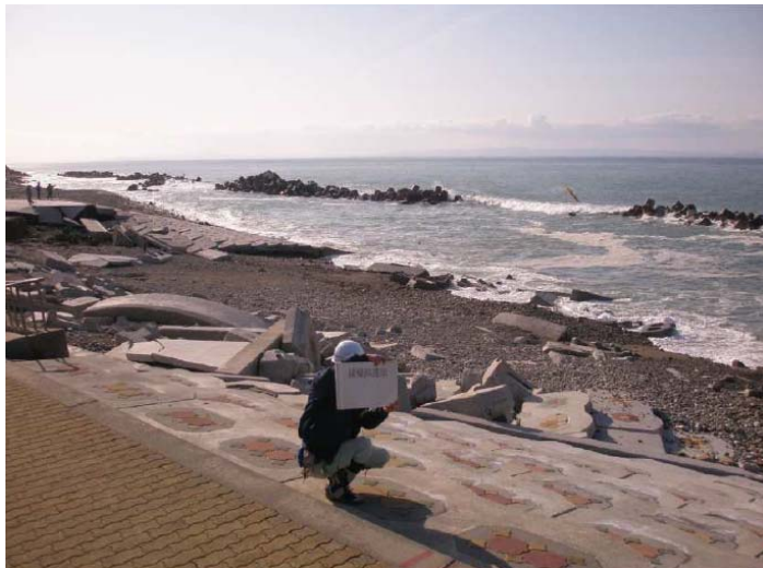
被災状況 富山県入善漁港海岸
