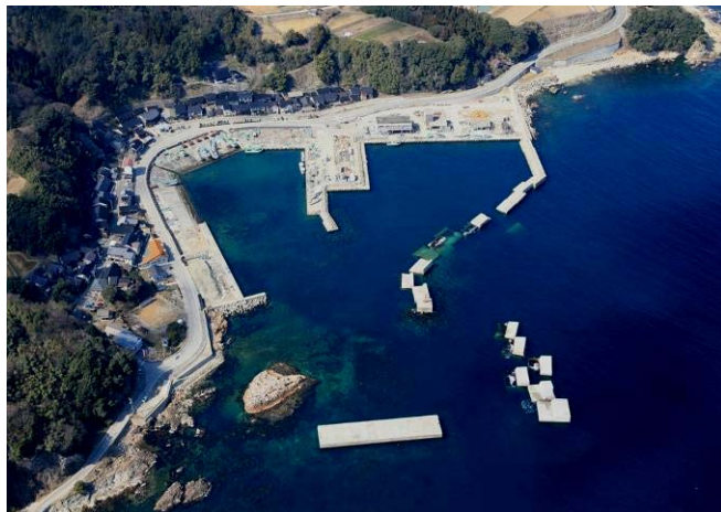
防波堤の滑動・転倒(水津漁港)
