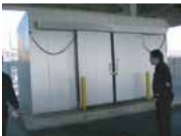
仮設のプレ ハブ簡易冷蔵 庫の設置
