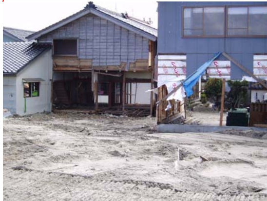
建物・家屋の損壊
