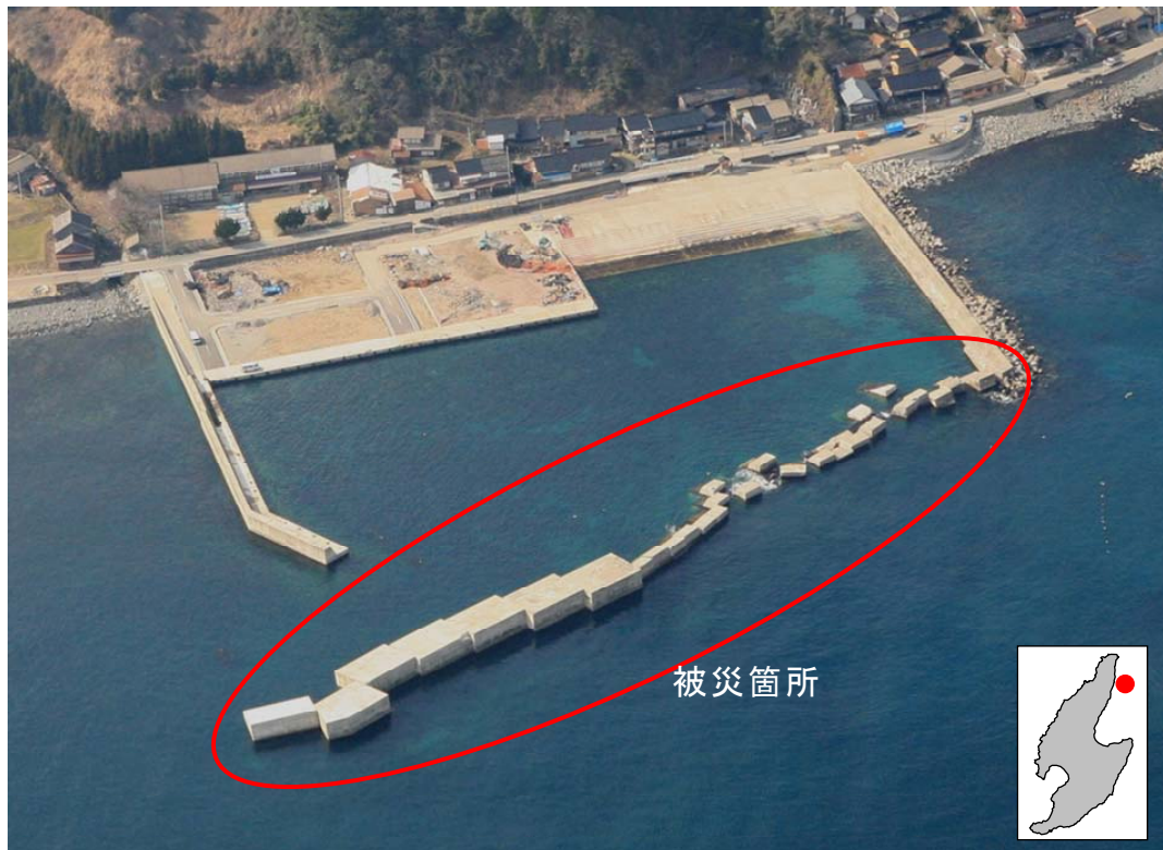
写真Ⅱ－2－10 北小浦漁港の防波堤の被災状況
