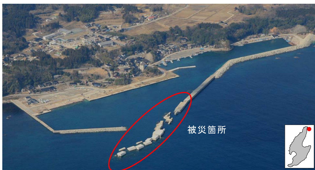
写真Ⅱ－2－9 鷺崎漁港の防波堤の被災状況
