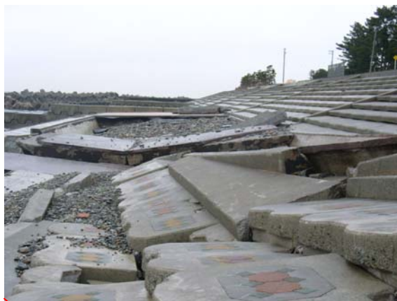
緩傾斜護岸のブロックの散壊
