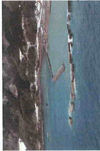
L=280m ケーン19函が滑動及び傾斜
