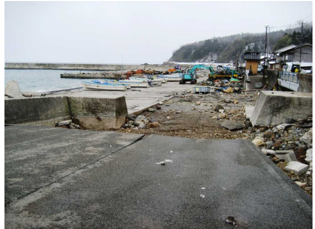
臨港道路の破損
