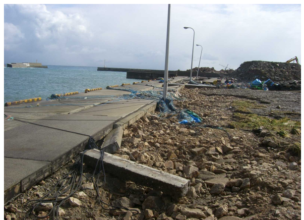
岸壁エプロン・照明灯の破損
