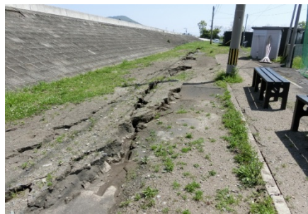
堤体の液状化
