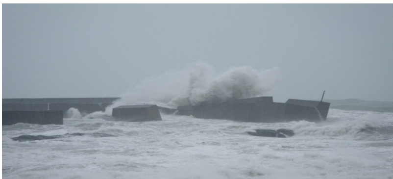
防波堤の損壊(和歌山県 動鳴気漁港(令和元年台風第19号))
