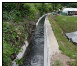
老朽化した用水路の整備・更新
