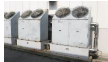
冷却機の機能強化（37.5kW→50.4kW）
