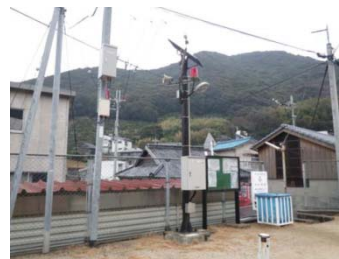
無停電電源照明 (和歌山県由良町 三尾川地区)
