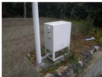
防災灯バッテリー (徳島県美波町 阿部地区)
