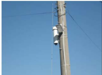
蓄電池内蔵避難誘導灯 (和歌山県広川町 唐尾地区)
