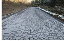
(損壊した道路の路面状況)
