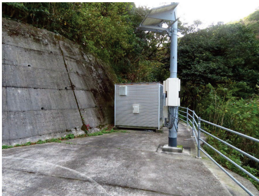
写真 2-2-2-4 備蓄倉庫の整備例
