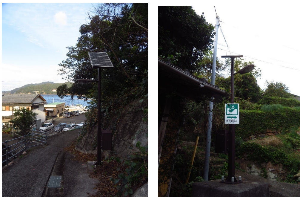
写真 2-2-1-3 太陽光発電システム付の避難誘導標識と照明
