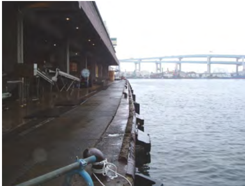
岸壁の孕み出し
