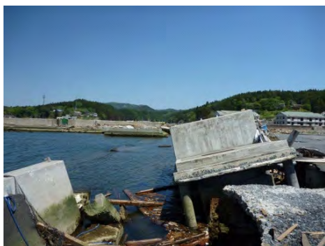
宮城県志津川漁港 (岸壁の被災)
