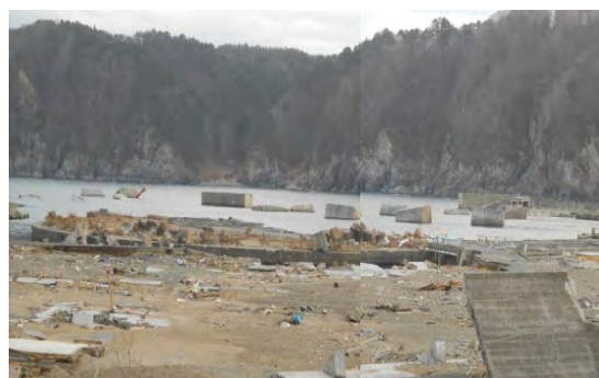
岩手県田老漁港 (防波堤・護岸等・ 防潮堤の被災)
