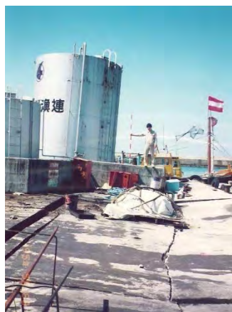
兵庫県南部地震による給油タンクの被害
