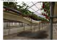
【ハウス内の設備破損】
