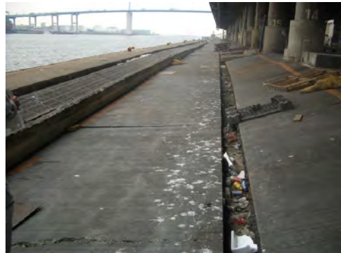
エプロンの陥没、荷捌所との段差
