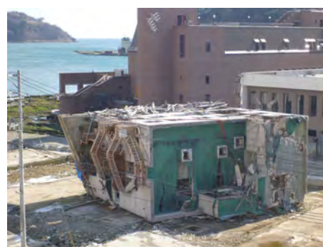
宮城県女川漁港 (鉄筋コンクリート 構造物の倒壊)
