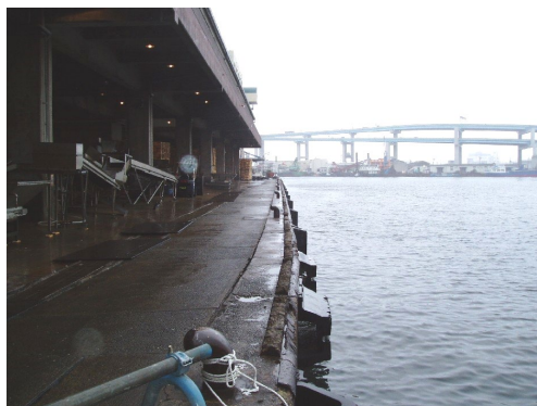
岸壁の孕み出し
