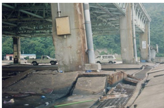
鳥取県西方沖地震(2000. 10. 6)による岸壁・ 荷捌所の被害
