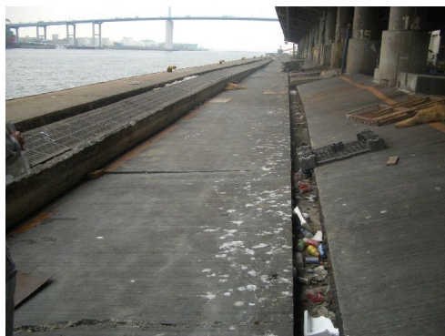
エプロンの陥没、荷捌所との段差
