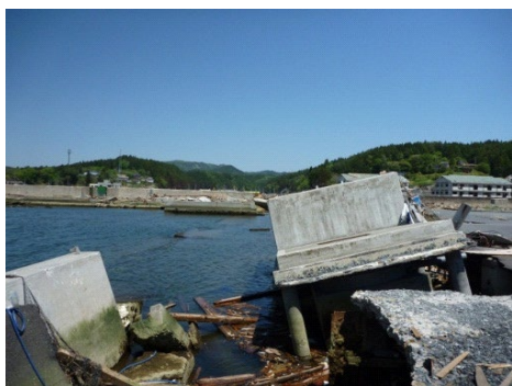
宮城県志津川漁港 (岸壁の被災)
