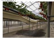
【ハウス内の設備破損】
