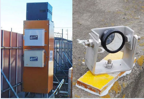
トータルステーション設置架台・プリズム
