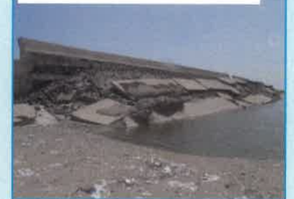
津波により洗掘された堤防
