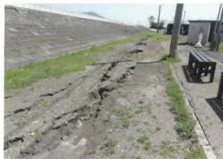
堤体の液状化
