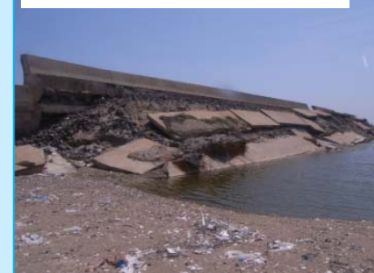
津波により洗掘された堤防
