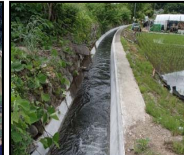
老朽化した用水路の整備・更新
