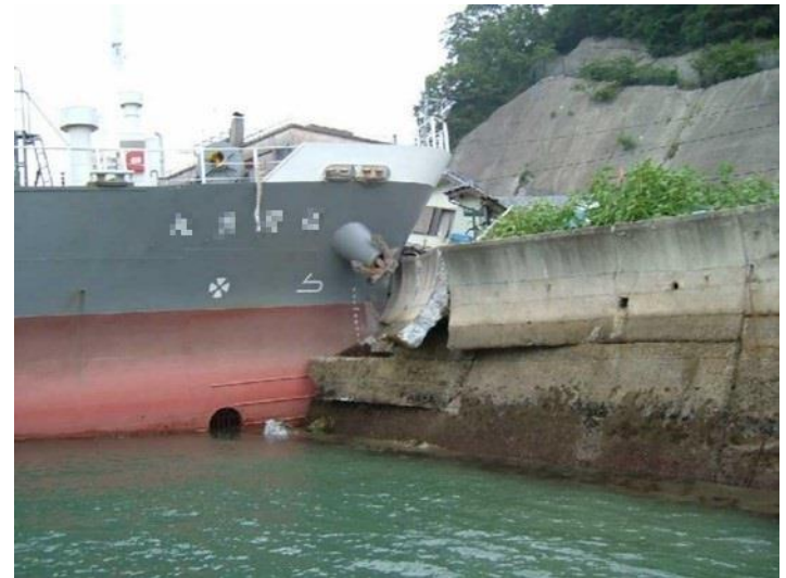
船舶が海岸保全施設を破壊した事例
