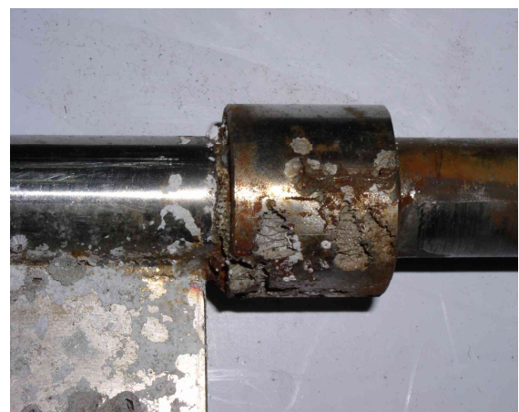
図 15 軸に溶接したリングに発生した粒界腐食
