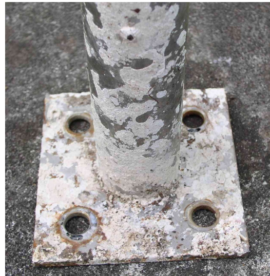
図 14 支柱脚部で発生した隙間腐食(穴の周りのボルト・ナットが接触していた部分が虫食い状に腐食)
