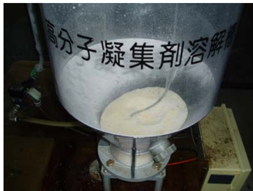
写真 - 7 高分子凝集剤溶解槽
