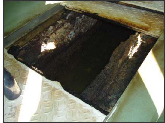
写真 - 2 流入部の腐食状況
