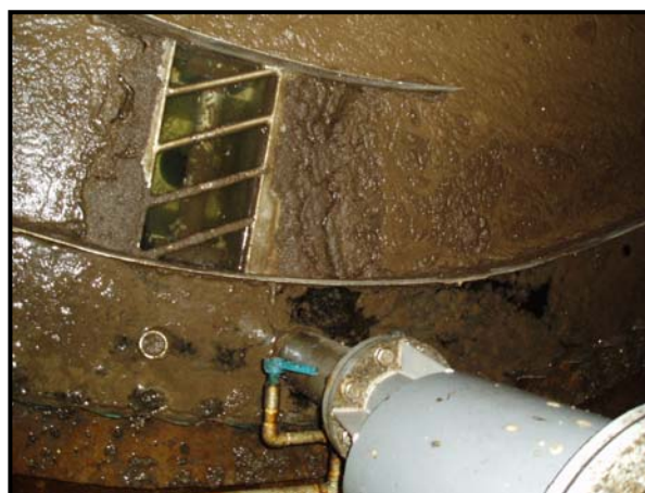
写真 - 6 沈殿槽での汚泥浮上
