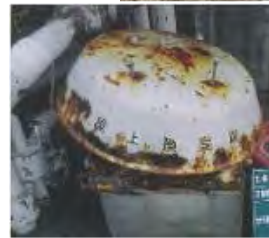
【換気施設の劣化状況】
