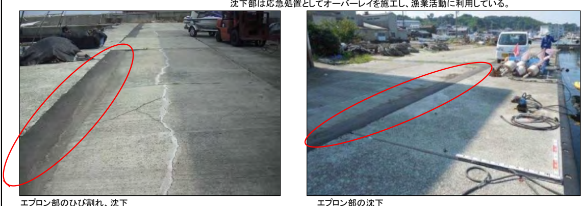
図 e-4-2-1(1) 保全対策実施箇所の老朽化状況(簡易調査等結果)
