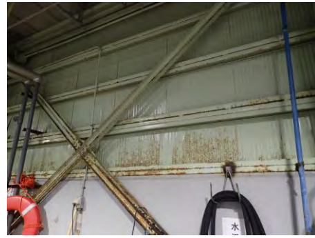
図 e-2-1-53 荷さばき所内壁の発錆状況
