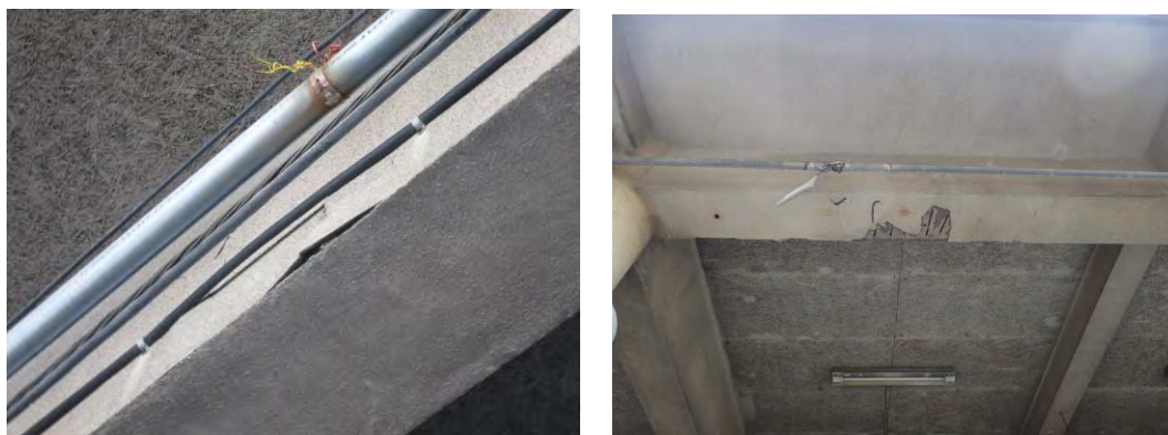
図 e-2-1-58 新港水揚場におけるモルタルの浮き、剥落状況
