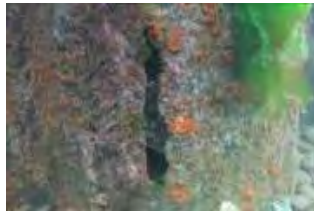
【鋼矢板の開孔：評価「a」】
