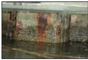
【鋼矢板の発錆：評価「c」】
