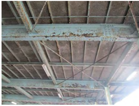
図 e-2-1-52 岸壁の屋根の梁の発錆状況
