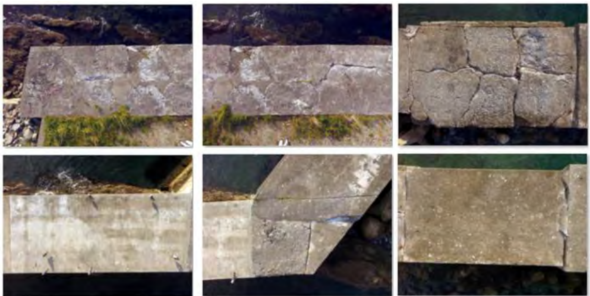
図 e-1-2-3-8 ひび割れ有りと判読された画像
