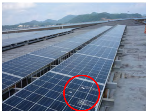
写真 3.4 太陽光パネル（パネル上の糞害）
