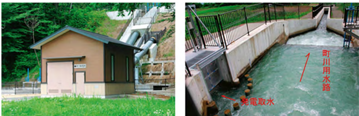
図 1.17 用水路発電設備の一例（町川発電所，最大出力 140kW） 6)
