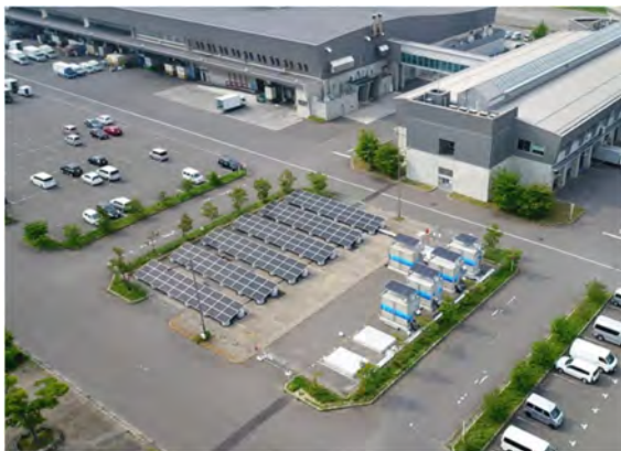
郡山市総合地方卸売市場に導入した 実証設備
