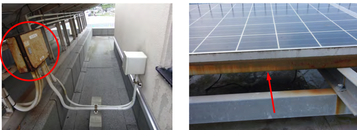
写真 3.1 漁港区域に導入された太陽光発電の塩害の事例
