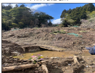
地震とがけ崩れにより住宅が全壊 (珠州市・大谷地区)
