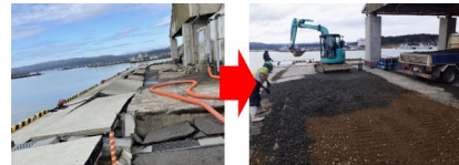
蛸島漁港(左:沈下状況、右:復旧作業状況)
