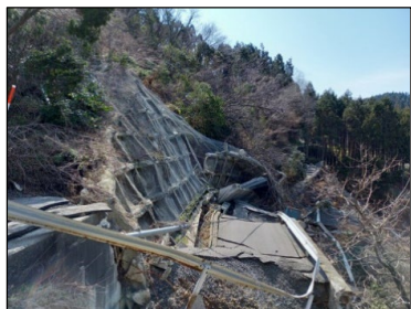
崖崩れにより道路が崩壊(輪島市・名舟地区)
