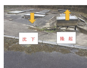
排水処理施設の被災状況(鹿波地区)
