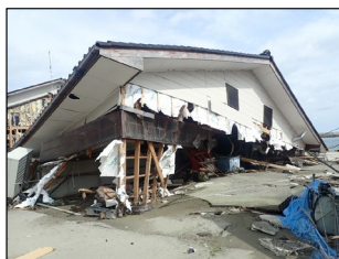
地震・津波により荷捌棟が全壊 (珠洲市鶴飼地区)
