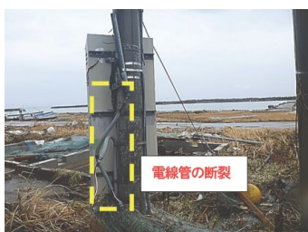
中継ポンプ操作版の被災
