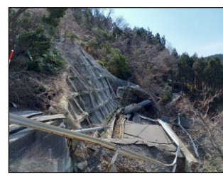
崖崩れにより道路が崩壊 (輪島市・名舟地区)
