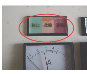
動力制御盤の被災
