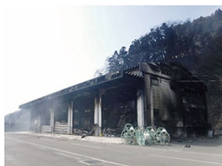
大船渡市の火災で被災した漁具倉庫 (水産庁HPより)
