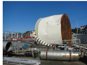
流された屋外貯蔵タンク(100kL)
