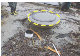
マンホール周囲の土壌洗堀
