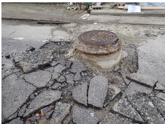
写真2-1 液状化により浮上したマンホール
