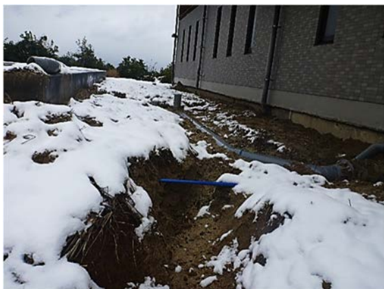
写真2-4 盛土部崩壊による配管露出
