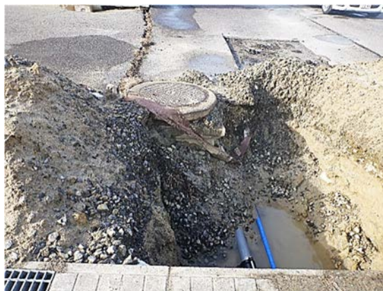
写真2-5 陥没による配管露出
