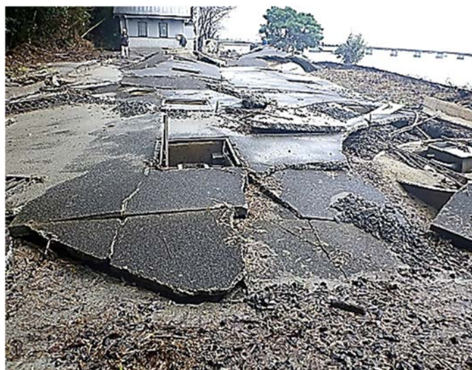
写真2-3 FRP製処理水槽の浮上被害例 ※散乱しているのは浄化槽の上部コンクリートスラブ
