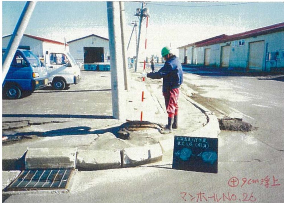
マンホールの浮上被害 （別海地区）
