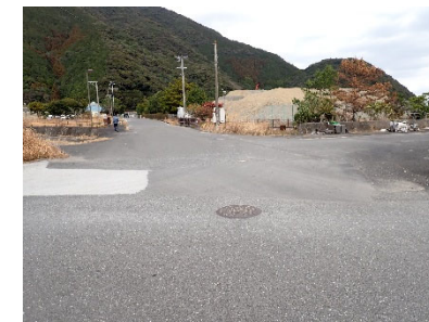
処理場付近管路沈下箇所
