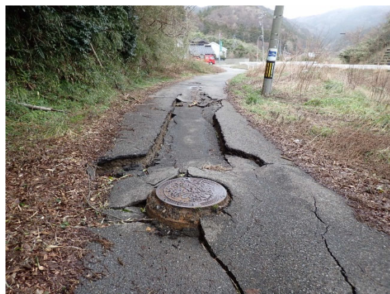
写真2-2 陥没した管きょ埋設部
