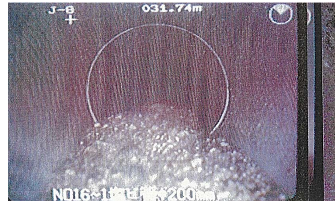
汚水管内での土砂堆積 （尾岱沼地区）
