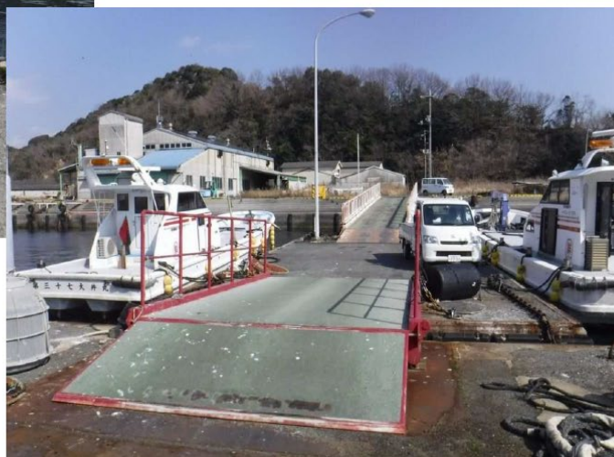
チェーン劣化状況
