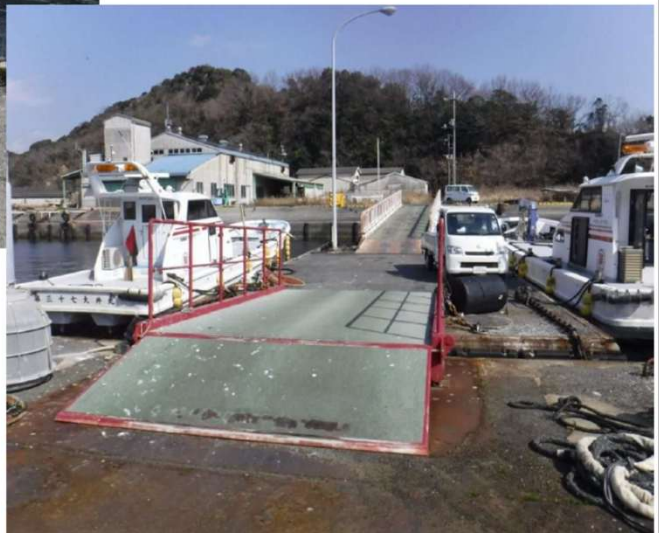
チェーン劣化状況
