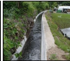
老朽化した用水路の整備・更新
