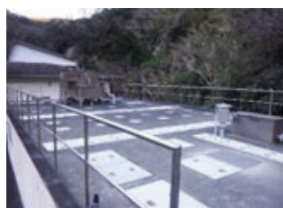
※漁港浄化施設：漁港における漁業活動等に伴い発生する汚水を処理する施設
