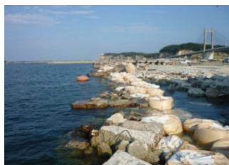
地震により岸壁が倒壊
