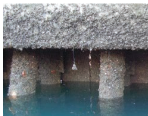
老朽化した岸壁
