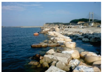
地震により岸壁が倒壊
