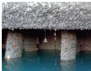
老朽化した岸壁
