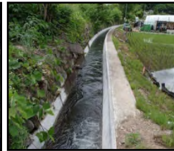
老朽化した用水路の整備・更新
