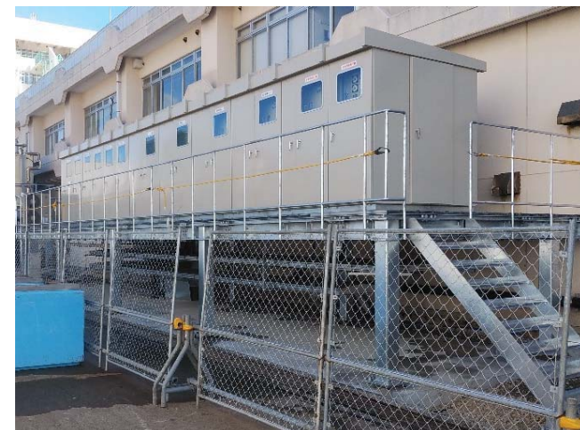
電源の高架化により浸水を防止
