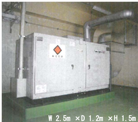
非常用電源の設置
