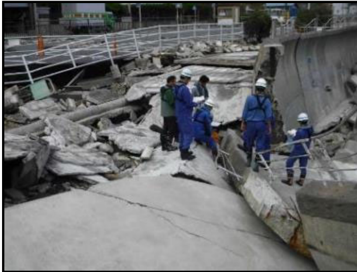
神奈川県横須賀市 高波による海岸護岸損壊
