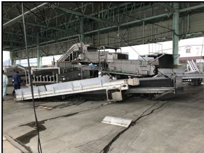
静岡県焼津市・焼津漁協 高潮浸水によるベルトコンベヤ損壊
