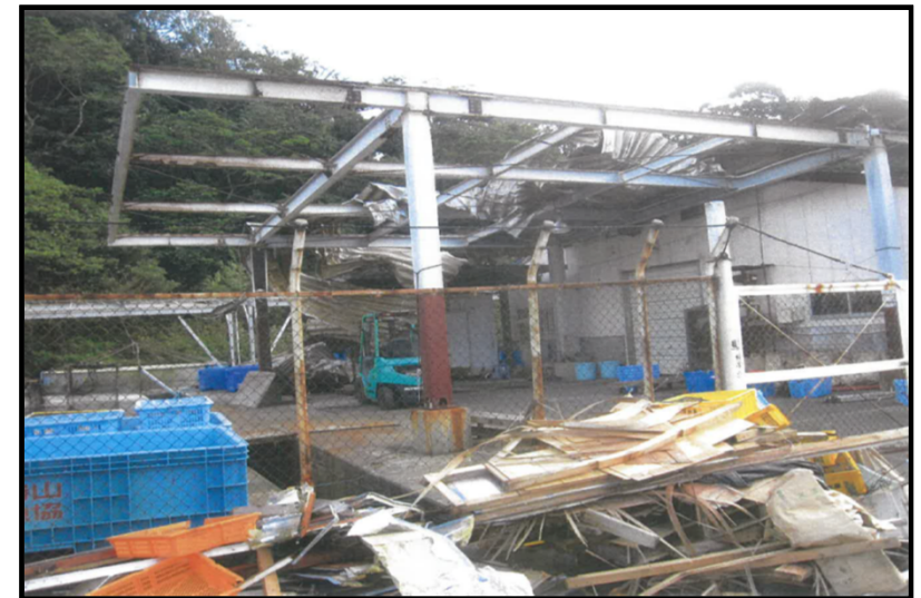
鋸南町・勝山漁協 蓄養施設の破損
