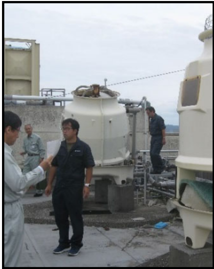
鴨川市・鴨川市漁協 冷凍冷蔵庫クーリングタワー の破損
