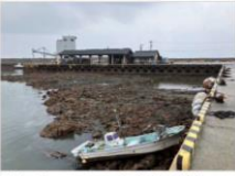
地盤に伴い、2～4m程度地盤が隆起。このため、防波堤の基礎がむき出しになり、泊地が平上になっている状況
