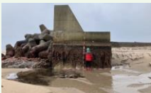
地盤隆起（鹿磯漁港）
