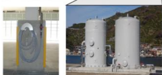
清浄海水導入施設
