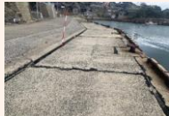
物場場の段差（富来漁港）
