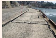
物場場の段差（富来漁港）
