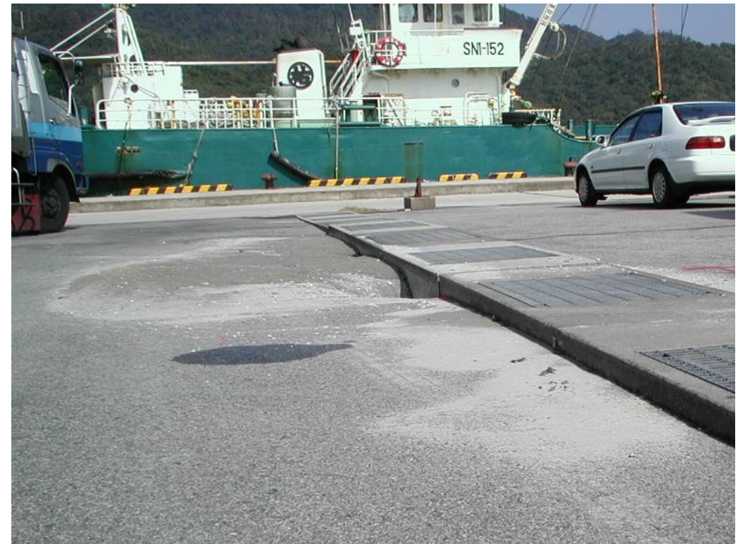
平成12年10月6日鳥取県西部地震 6号岸壁が地震により陥没
