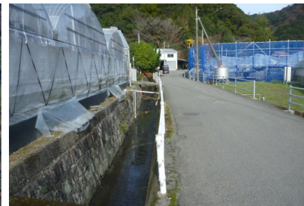
幅員が狭隘なため、 車両同士の離合が困難
