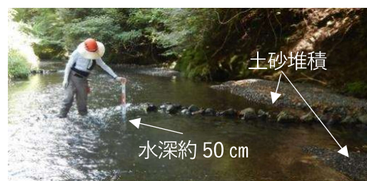
写真 1 バープ工周辺の土砂堆積と洗堀の様子 (足俣川)
