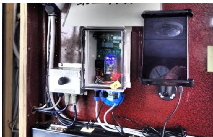
図 31-2 観測協力漁船のロガー設置状況
