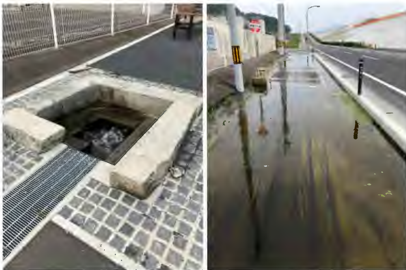
図 4-18 調査地北部の県道 231 号にて確認された湧水状況
