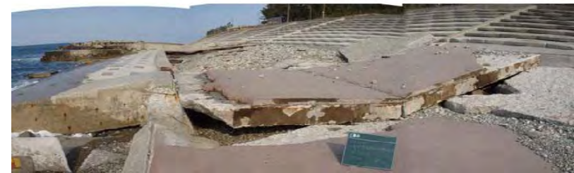
波によるブロック散乱→護岸崩壊
