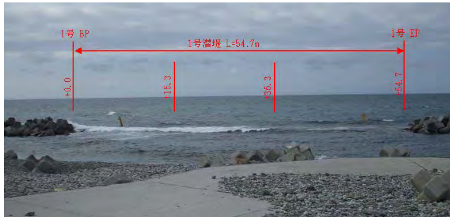
波によるブロック散乱・流出
