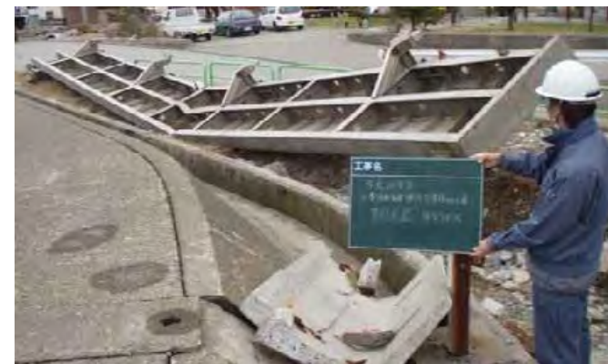
波力によるゲート破損
