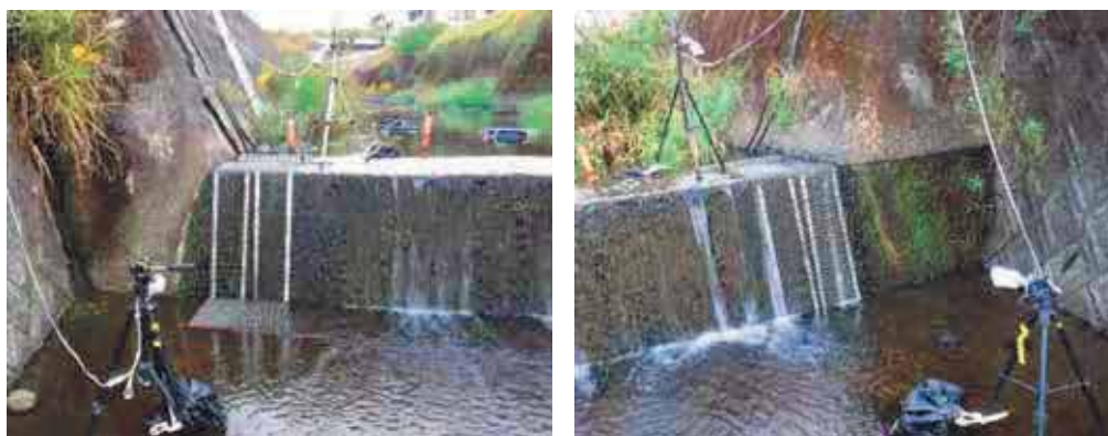
図 5 金網魚道と監視カメラ (左: Z 型魚道 右: L 型魚道)
