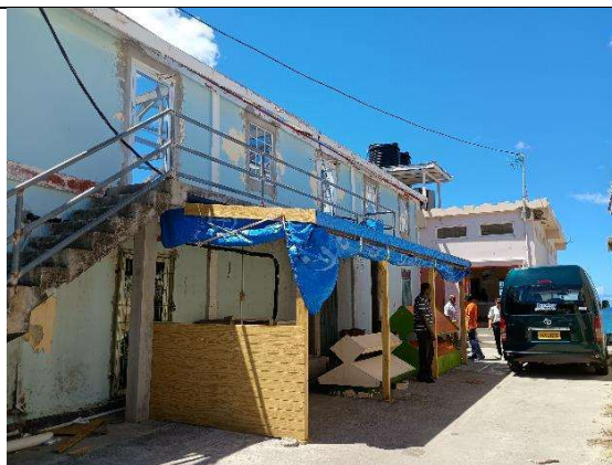
ヒズボロ水揚場の入口（ハリケーン被害によ って窓や屋根が破損している）
