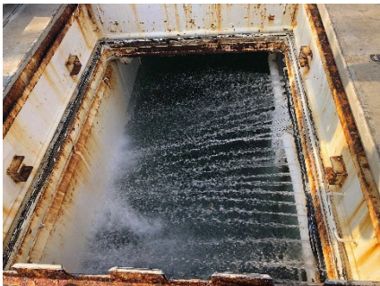
循環ポンプ(テスト時)
