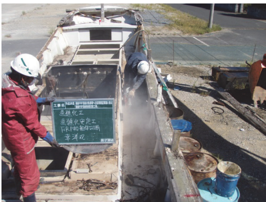
写真-5.6 切断状況(キャビン)
