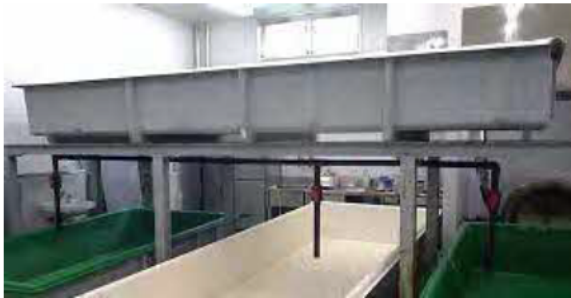
図1 上段の水槽の設置状況
