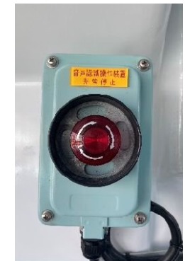
非常停止 ボタン
