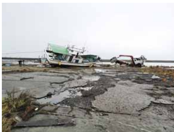
地震により岸壁が損傷し、 津波により漁船が乗り上げた様子 (鵜飼漁港)
