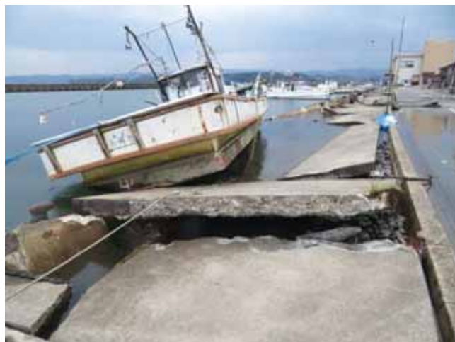
地震による物揚場の沈下と割れ (石崎漁港)
