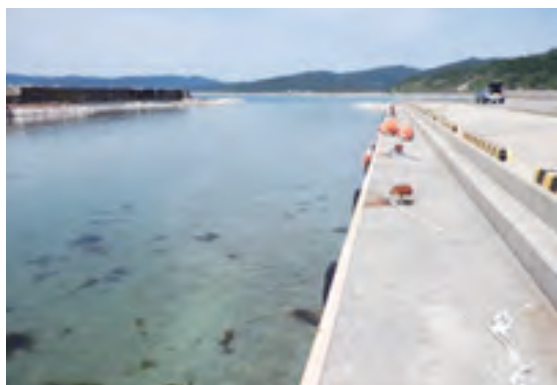
（被災後） 地盤隆起により、泊地埋そく
