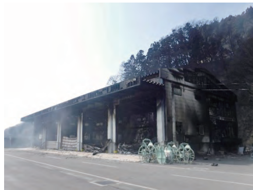
被災した倉庫
