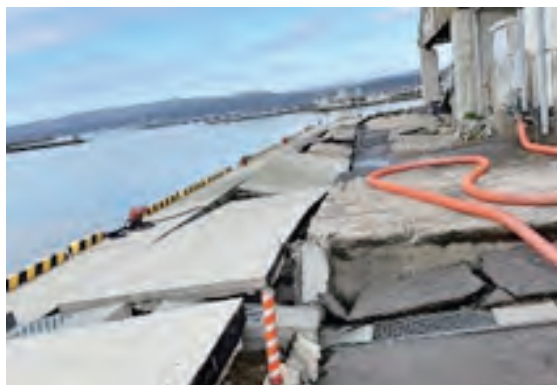
（被災後） 岸壁のエブロン背後が沈下
