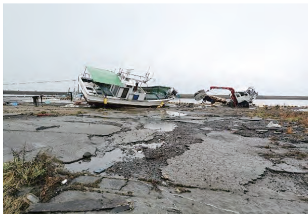
地震により岸壁が損傷し、 津波により漁船が乗り上げた様子 ( うかい 鵜飼漁港)
