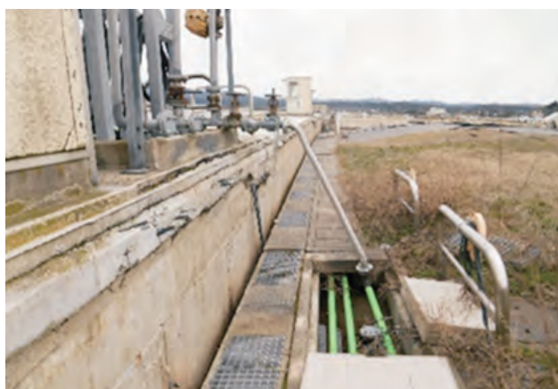
地震による給油施設の損傷 ( たこしま 石川県蛸島漁港)
