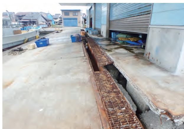
地震による荷捌所の損傷 ( みずはし 富山県水橋漁港)
