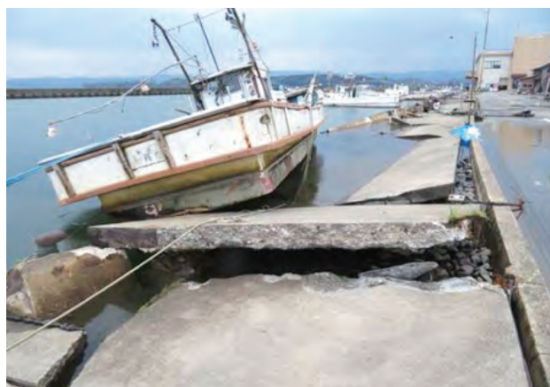
地震による物揚場の沈下と割れ (石崎漁港)
