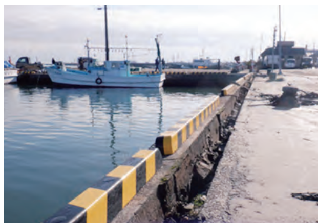
地震による物揚場の傾倒と沈下 (富山県新湊漁港)
