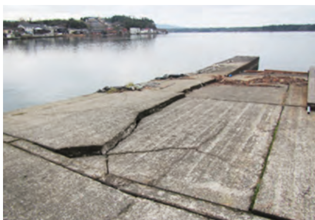
地震による船揚場の損傷 (新潟県両津漁港)
