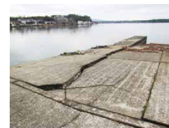
地震による船揚場の損傷 (新潟県両津漁港)
