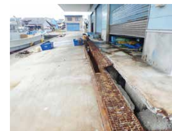
地震による荷捌所の損傷 (富山県水橋漁港)
