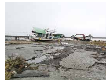
地震により岸壁が損傷し、 津波により漁船が乗り上げた様子 (石川県鶴飼漁港)
