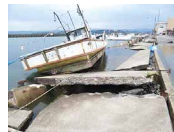
地震による物揚場の沈下と割れ (石川県石崎漁港)
